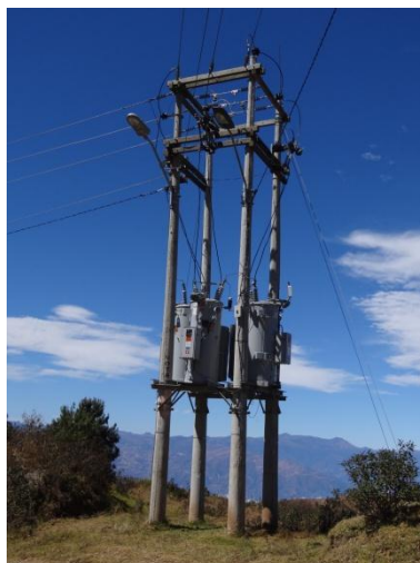
Ilustración 34: Transformadores de energía de la zona alta del cantón.
