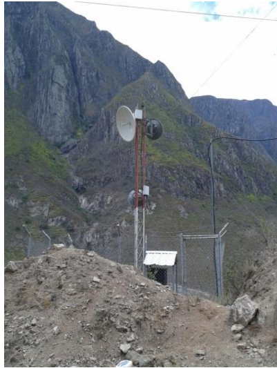
Ilustración 29: Antena de cámaras en el Sector de San Francisco.
