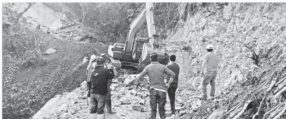
Maquinaria pesada realiza apertura vial en Ducuburi y San José de Buriacu
