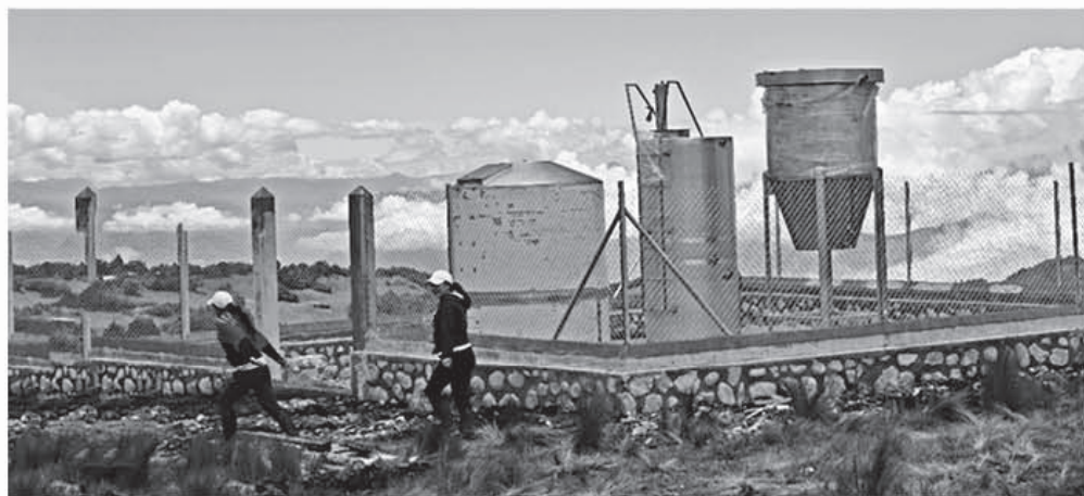
Construcción del sistema de agua potable en San José de La Betania
