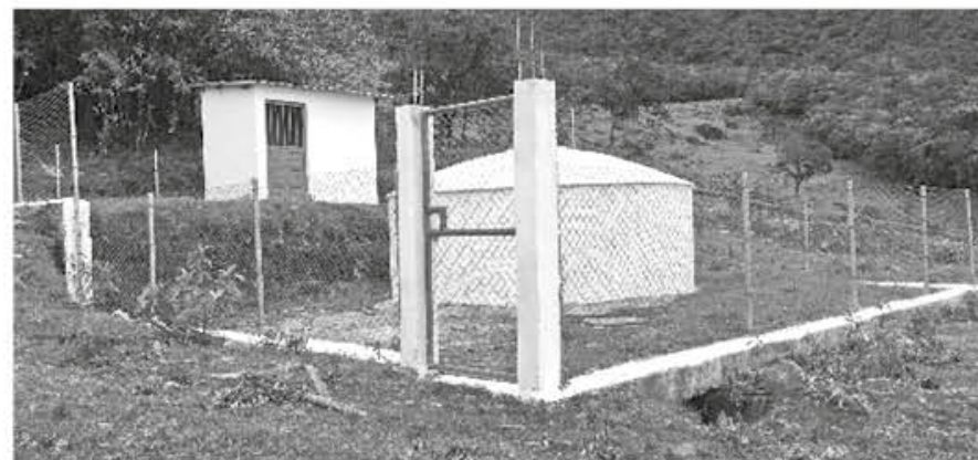
Sistema de agua potable en San Miguel de las Palmeras
