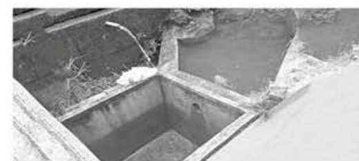
Sistema de agua potable en Vivar Alto
