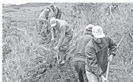
Habitantes de San José de La Betania aportan con mano de obra no calificada para la construcción del sistema de agua potable.
