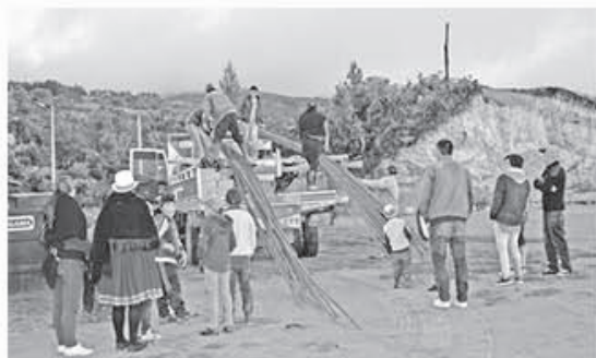
Habitantes de la comunidad Las Nieves reciben materiales para la construcción del sistema de agua potable.
